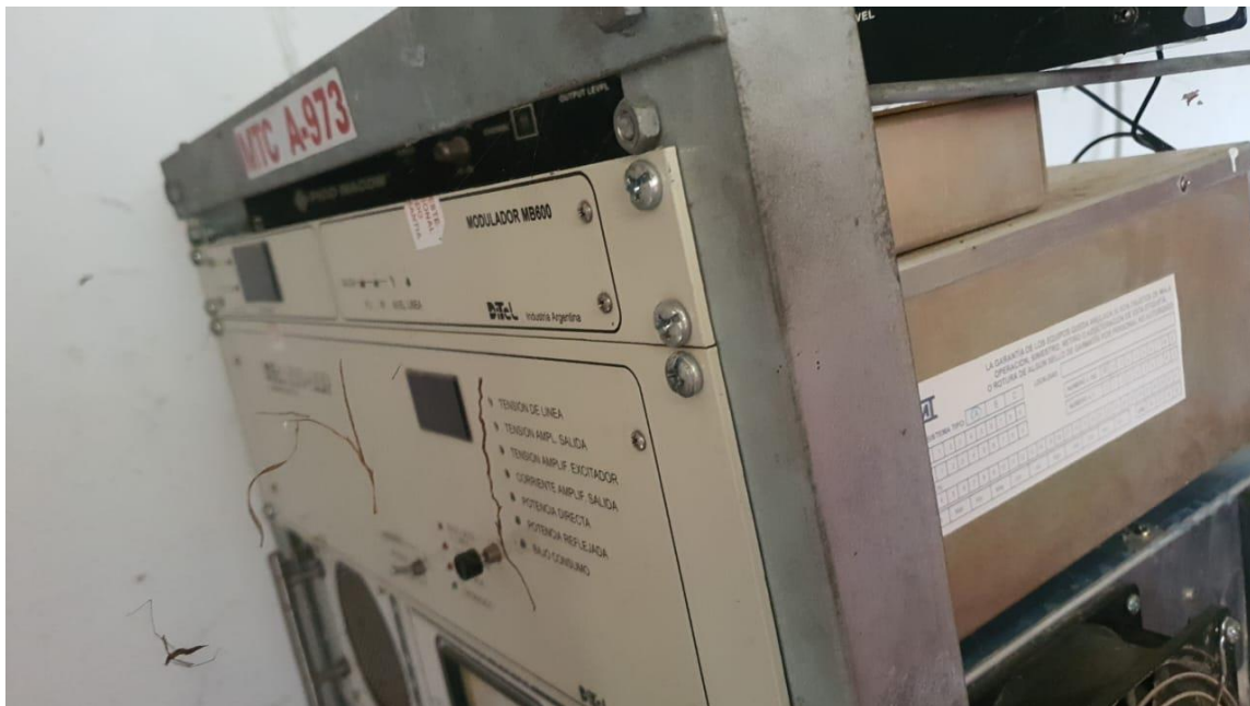
Figura 4. Equipos transmisores Inoperativos y para mantenimiento.
