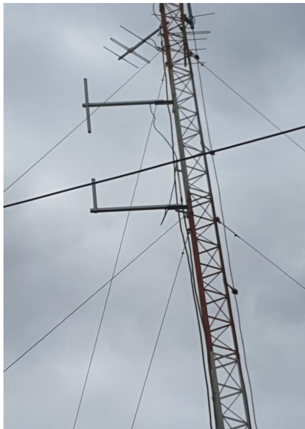
Figura 2. Estado regular de antenas tipo yagui y dipolos, también se aprecia cuerpos de torre despintados.
