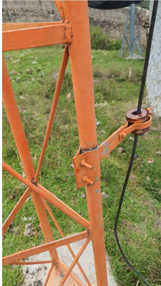
Figura 3. Cuerpo de torre despintada así como templadores y cerámicos en estado regular.
